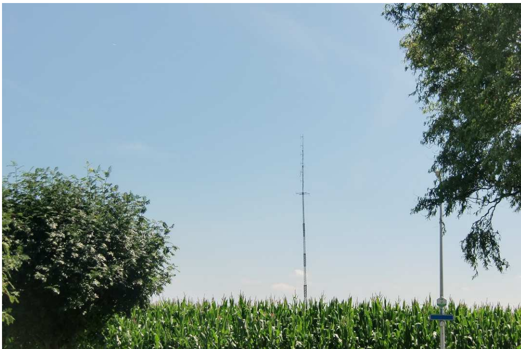
Ein weiterer Mobilantennenanlage
